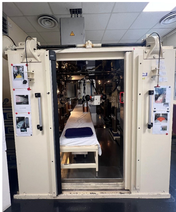
Figure 3 : Installation d'anthropogammamétrie fixe du SPRA (Source : SPRA).
